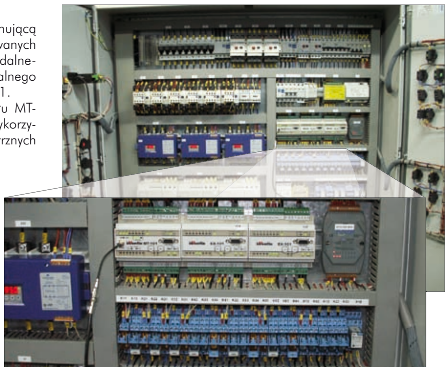
Zdjęcia szafy sterowniczej z zainstalowanymi modułami telemetrycznymi
